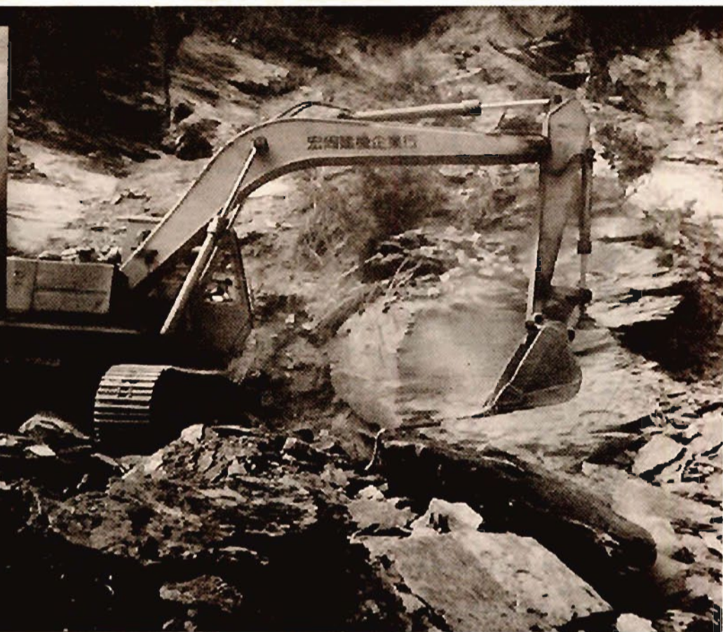
颶風過後南隘寮溪沿岸坍塌阻斷新好茶的交通 圖\野人
